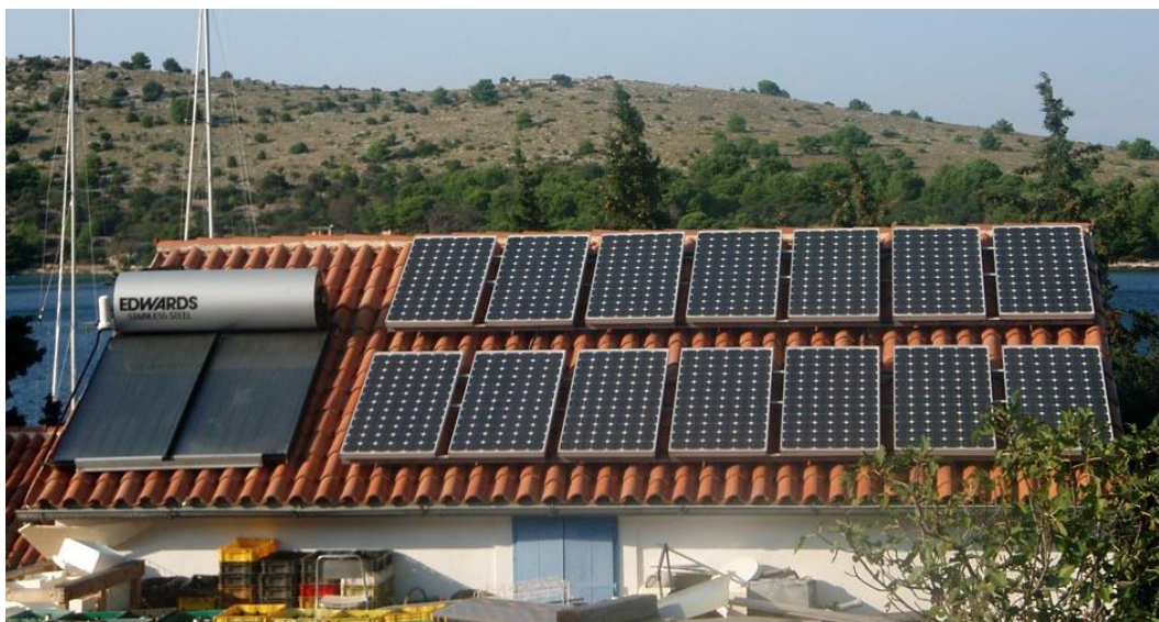
Slika 6: Solarni kolektori obitelji Mudronja na Žutu
