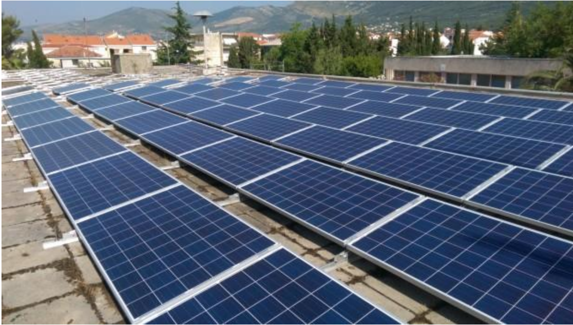
Slika 16 Solarni paneli na krovu škole
