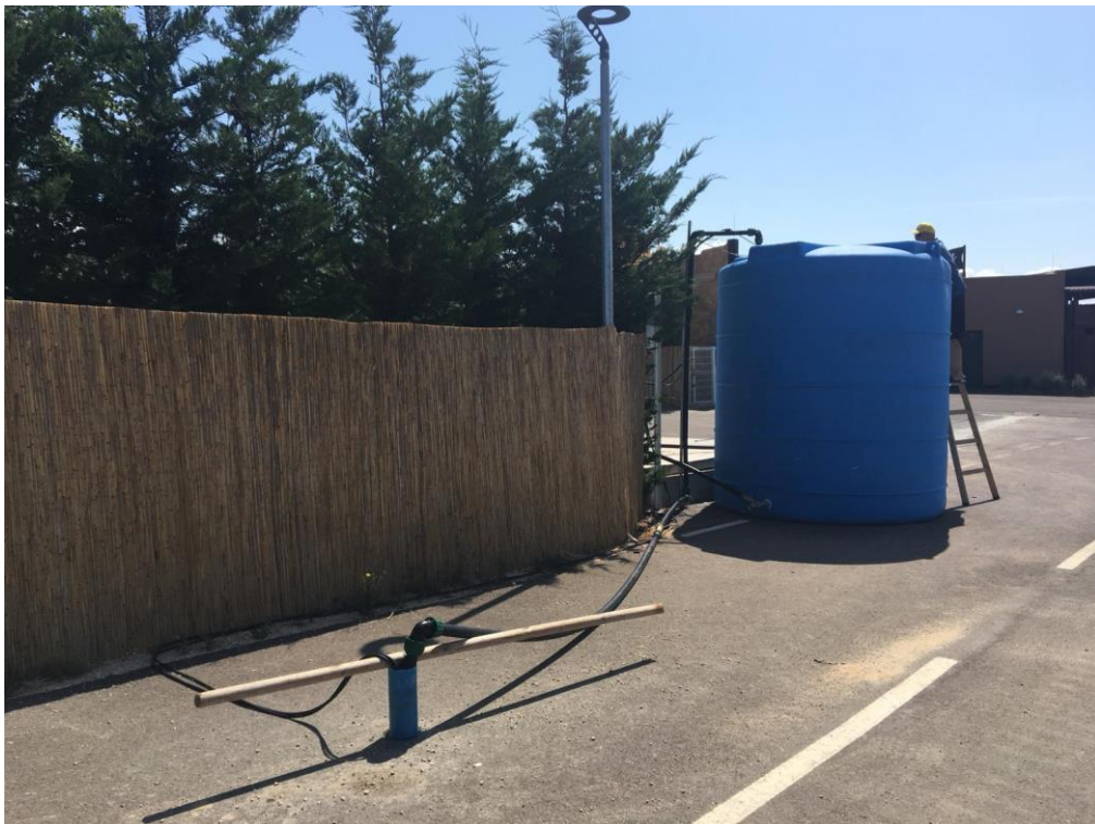
Slika 18. Sustav za pribavljanje vode iz bušotine s dubine 30 m
